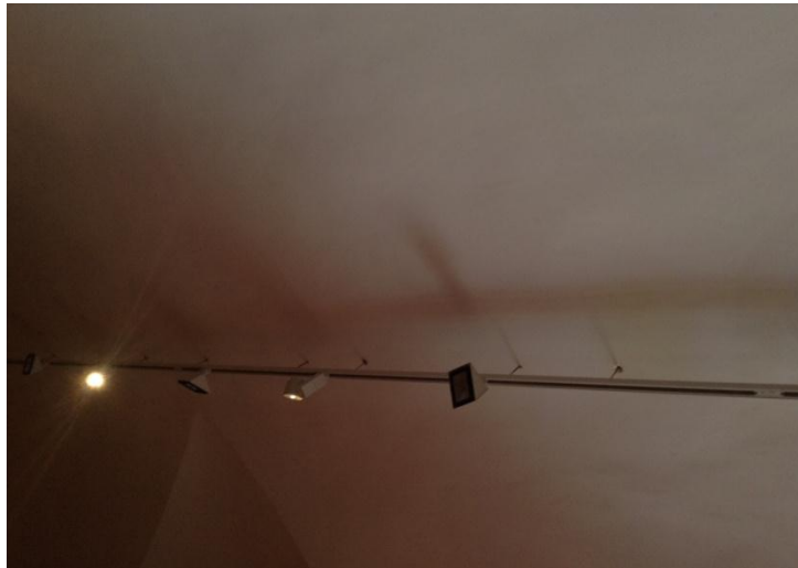
( الصورة رقم 34: صورة للإضاءة المعطلة)
